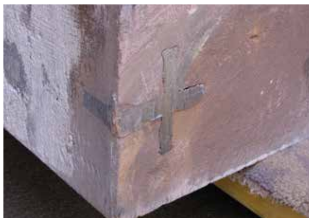
Abb. 20 Eine Bleiplombe in einer Ecke des Maßwerks. Foto 05.07.2022.
