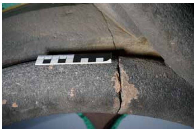
Abb. 102 Bruchstelle im zentralen Okulus des Rosenfensters. Foto 26.07.2022.
