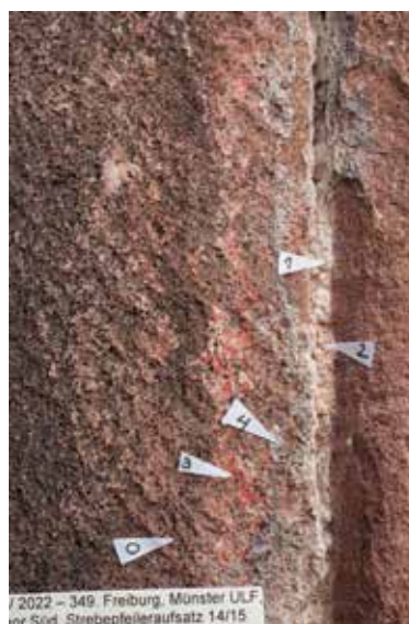
Abb. 126 Farbreste an einer Fuge. Foto 13.07.2022.
