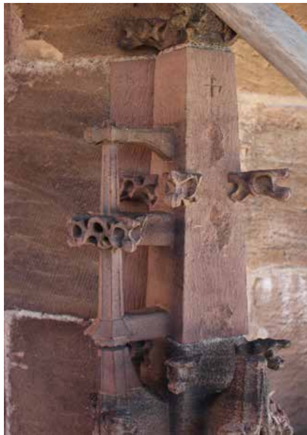
Abb. 12 Schadhafte Fialenteil aus der Renovierungsphase der 1930er am Freiburger Münsterchor. Foto 11.07.2022.
