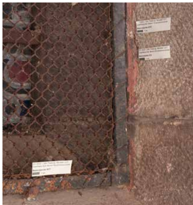
Abb. 62 Wandflächen unter der Renaissancevorhalle. Rötliche Farbreste am Gewände des Fensters, in der Nähe des Fenstergitters, wo der Stockhammer nicht eingesetzt werden konnte. Foto 13.07.2022.
