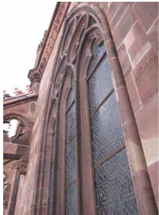
Abb. 134 Neue Vernetzung am Fenster am nördlichen Langhaus. Foto 18.09.2022.
