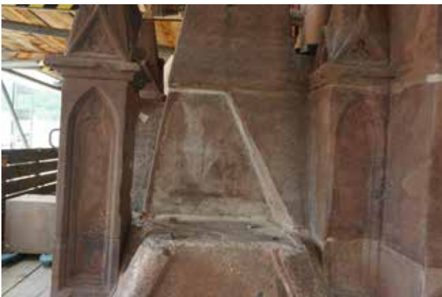
Abb. 77 Der Figurenbaldachin des Strebepfeilers 0/0 mit fehlender Giebelspitze. Foto 12.05.2022.
