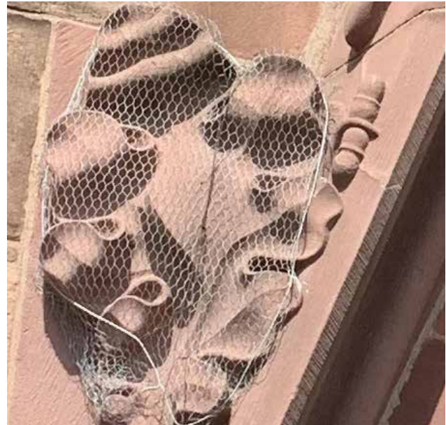
Abb. 118 An den Turmwimpergen wurden zahlreiche schadhafte Krabben vorsorglich eingensetzt. Teleskopbild 28.10.2021 (Dr. Martin Federspiel).
