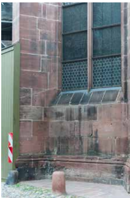
Abb. 124 Die südliche Kaiserkapelle vor der Reinigung. Foto 10.05.2021.
