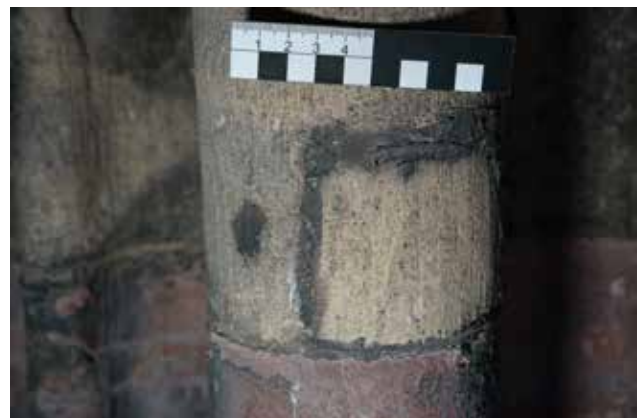
Abb. 99 Bauzeitliche Vierung, deren Klebestelle im 19. Jahrhundert überspachtelt wurde. Foto 26.07.2022.
