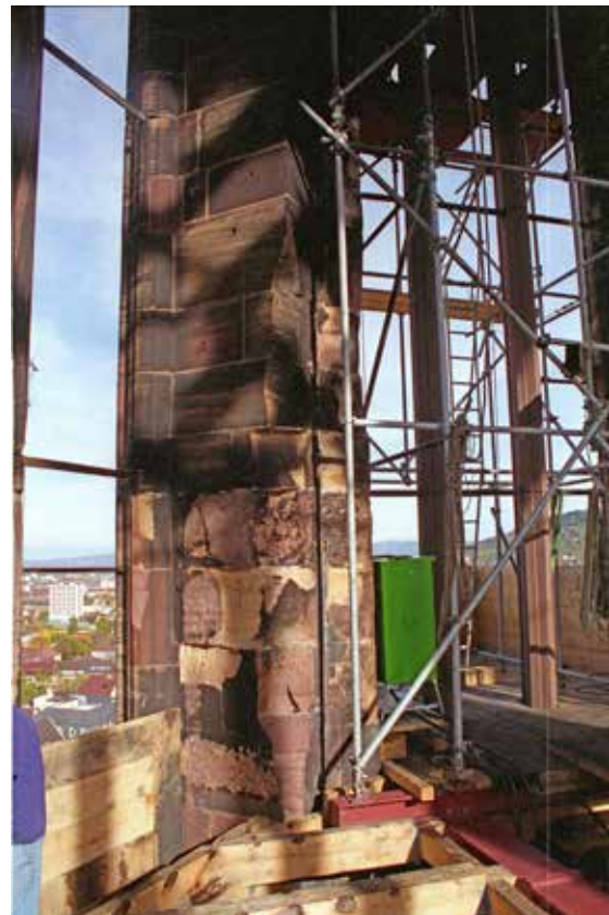
Abb. 115 Baustelle der 1990er Jahren mit Brandschäden am Oktogon. Foto von 1994 (MBV Archiv).
