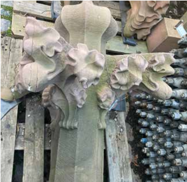
Abb. 117 Im Hof der Bauhütte gelagerte Kreuzblume vom Turmoktogonal mit der typischen Rissbildung des Freudenstädter Plattensandsteins. Foto 20.03.2023.
