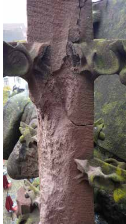
Abb. 131 Fiale am Chorstrebepfeiler 10/11 Süd. Endfestigung des verwendeten Plattensandsteins und Rissbildung haben den tragenden Querschnitt auf etwa 1/3 reduziert. Foto 28.09.2022.
