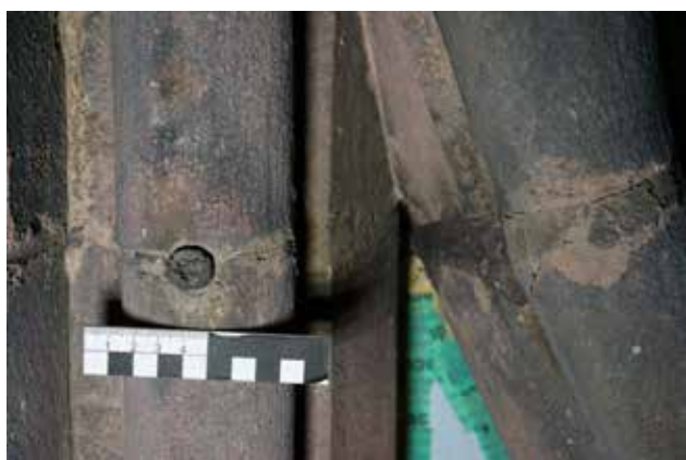
Abb. 100 Holzdübel aus dem 19. Jahrhundert zur Befestigung eines Netzes zum Schutz der Glasscheiben. Foto 26.07.2022.
