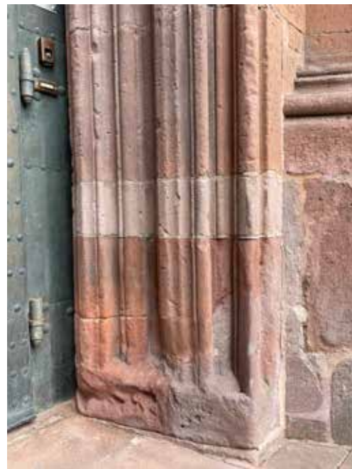
Abb. 6 Rechtes Gewände des Marienportals. Die große Fehlstelle wurde geschlossen. Das Wasser kann jetzt über dem Profil wieder ablaufen. Foto 18.07.2022.
