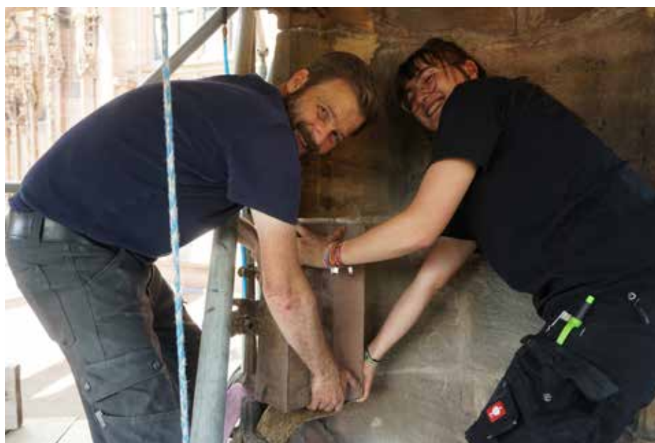
Abb. 13 Der Ausbau des schadhaften Fialenteils am Chorstrebepfeiler durch Joachim Stöhr und Pia Schartel. Foto 13.07.2022.
