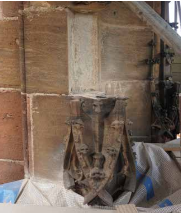
Abb. 14 Der Strebepfeiler mit fehlendem Fialenstück. Foto 13.07.2022.
