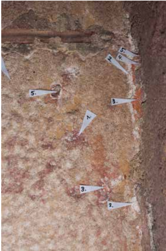
Abb. 64 Wandflächen unter der Renaissancevorhalle. Teilbereich von Befund 014. Foto 21.11.2022.
