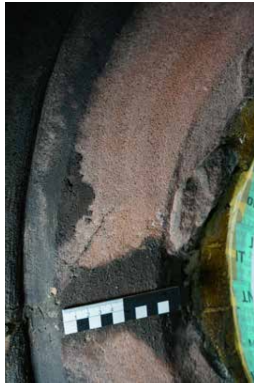
Abb. 107 Reste der abgearbeiteten Maßwerknasen des zentralen Okulus. Foto 20.07.2022.
