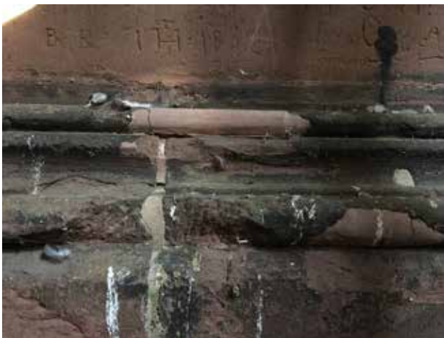
Abb. 3 Detailaufnahme des Vorzustandes mit alter defekter Ergänzung (die Antragung war lose und gerissen). Foto 04.05.2022.
