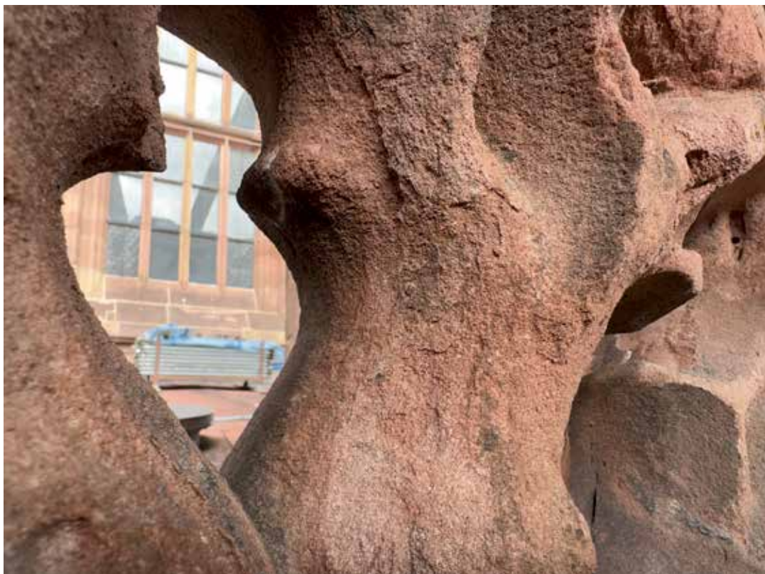
Abb. 25 Ein stark geschädigtes Steingefüge am Maßwerk im Joch 13. Foto 11.10.2022.
