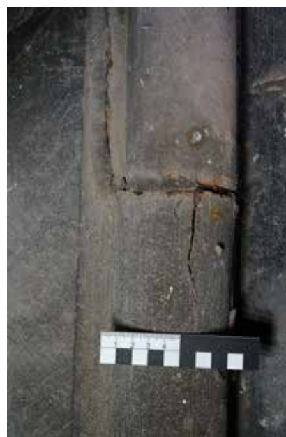
Abb. 103 Nachträglich eingebrachte Eisendübel. Foto 26.07.2022.
