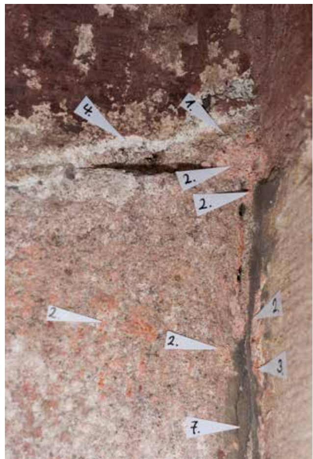
Abb. 63 Wandflächen unter der Renaissancevorhalle. Teilbereich von Befund 011. Foto 21.11.2022.
