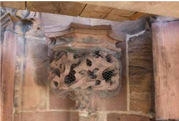
Abb. 15 Schadhafte Konsole aus der Renovierungs- phase der 1930er am Freiburger Münsterchor. Foto 11.07.2022.
