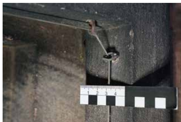
Abb. 101 Metallösen zur Befestigung eines Netzes zum Schutz des Rosenfensters. Foto 26.07.2022.
