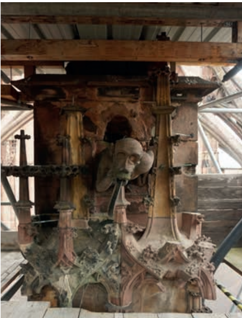
Abb. 26:Vorzustand Wasserspeier „Affe“ mit dem Wasserrohr aus dem 19. Jh. 19.04.2023 (MBV, T. Borsdorf)
