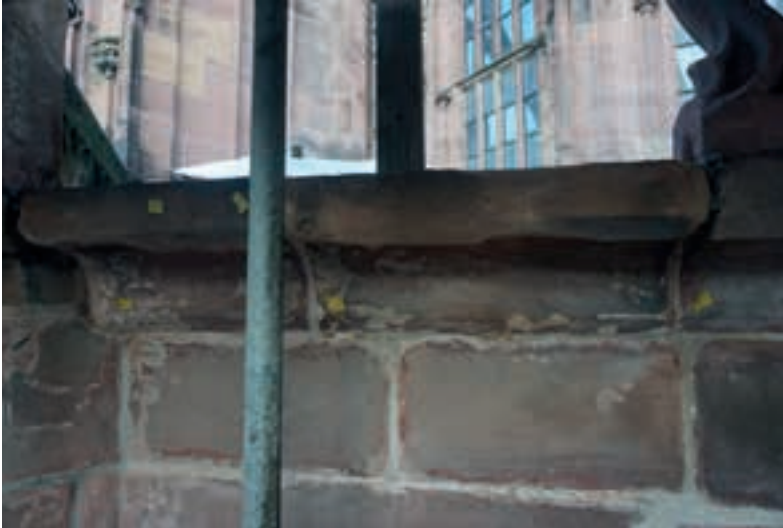
Abb. 35: Das Dachgesims, Joch 13 WS 2, vor der Maßnahme 14.02.2023 (MBV, A. Schedlbauer)
