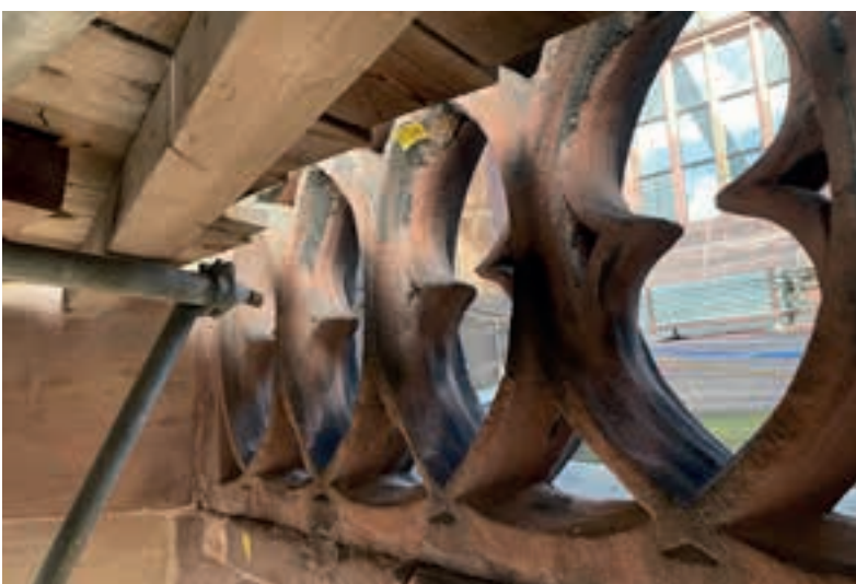
Abb. 39: Maßwerkbrüstung, Joch 14 WS1, Schnewlin-Kapelle, im Vorzustand, 10.10.2023 (L. Kürten)
