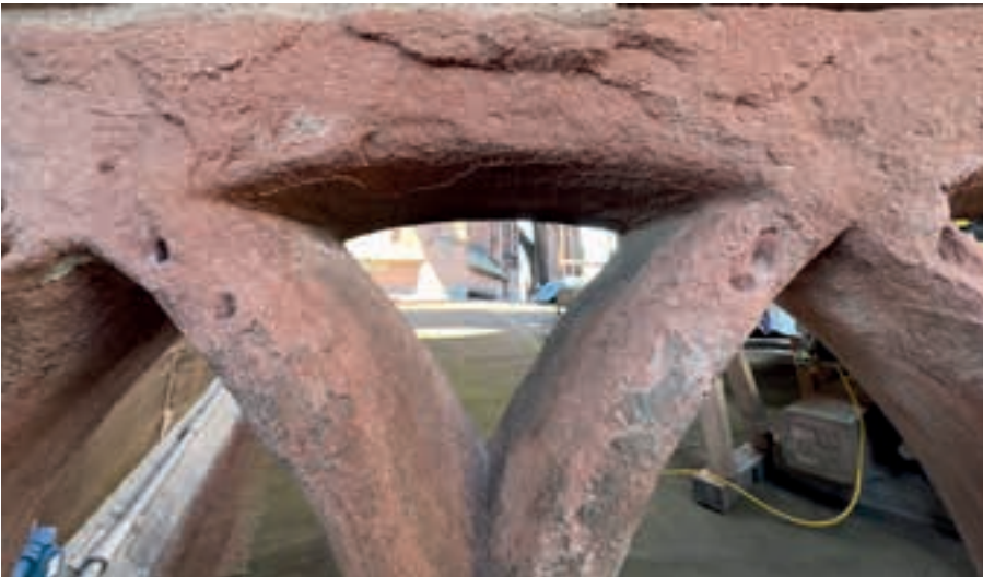
Abb. 41: Ausschnitt des rechten Maßwerks mittig, oben im Vorzustand. Der Bereich ist stark zurückgewittert, 06.09.2023 (L. Kürten)
