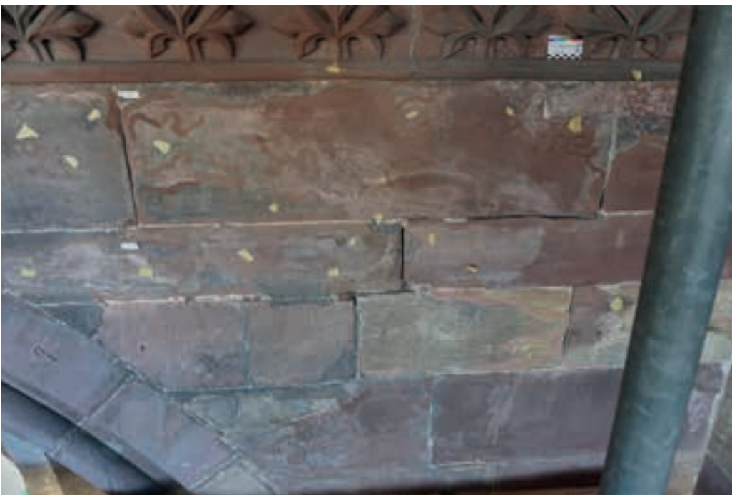
Abb. 82: Zwischenzustand Wandfläche Joch 1, die Aufkleber markieren bereits durchgeführte Maßnahmen, 28.05.2024 (MBV, A. Schedlbauer)
