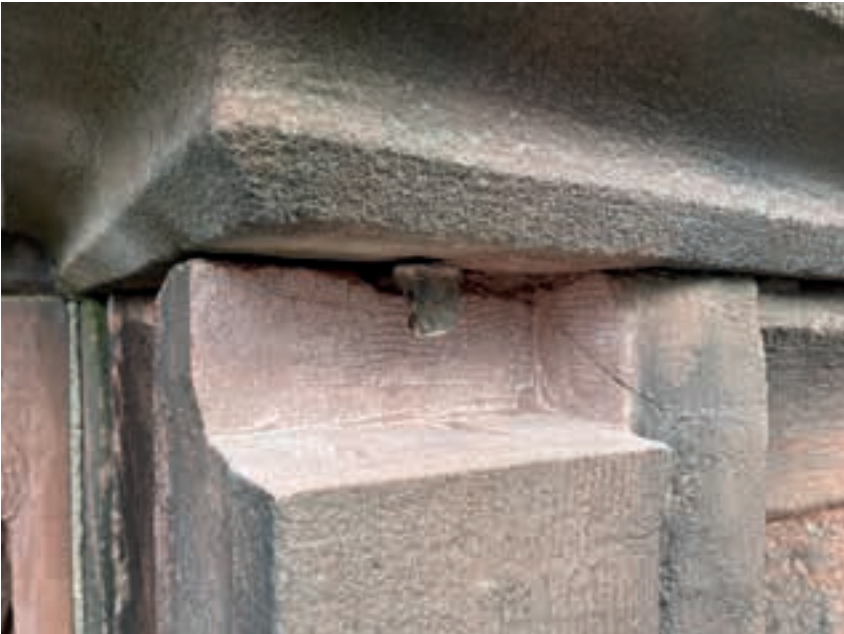
Abb. 90: Korrodierte Klammer am Kapellenfeiler 13 Süd, diese wurde vor Einbringen der Vierung ausgebaut, 07.11.2023 (MBV, T. Borsdorf)
