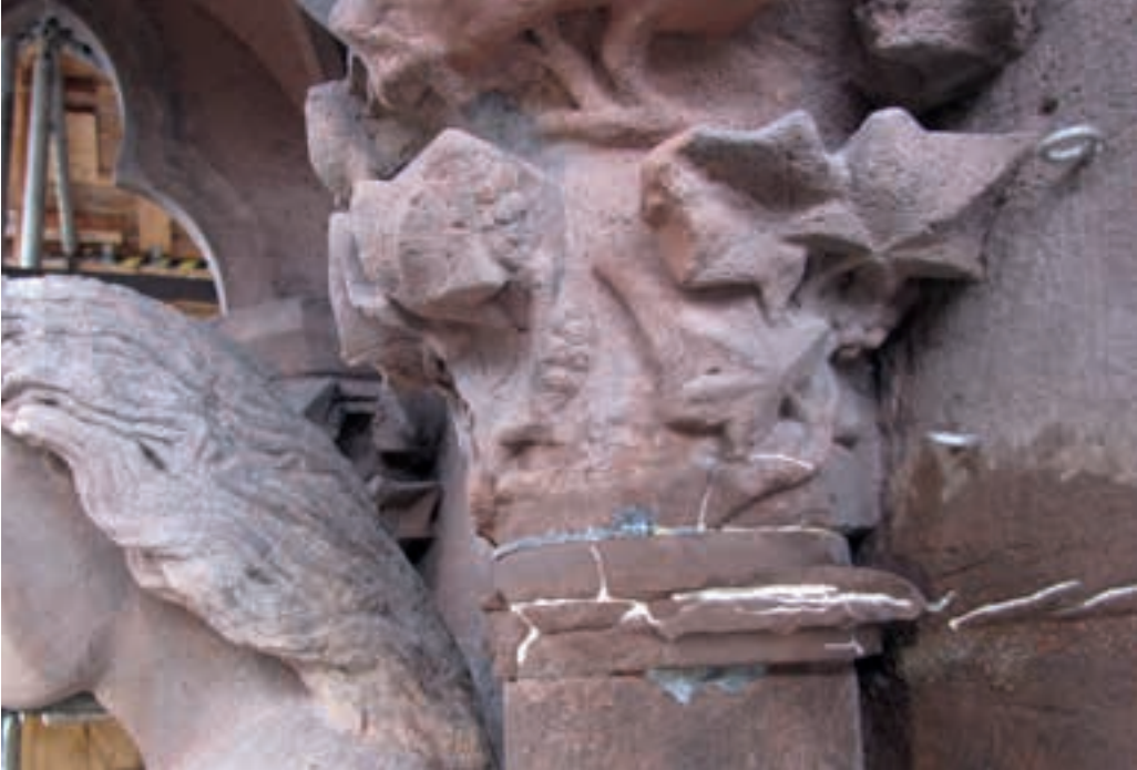
Abb. 55: Die verfüllten Risse vor der Kittung 29.08.2023 (MBV, A. Schedlbauer)
