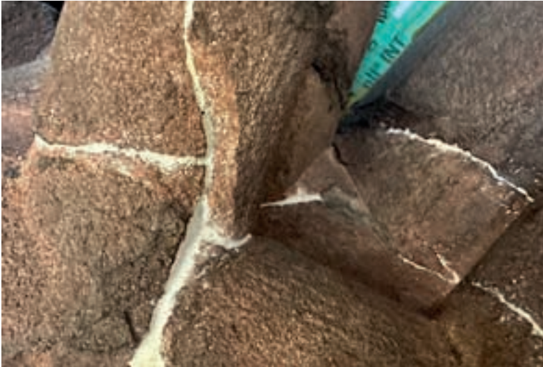
Abb. 72: Injizierte Risse (weiße Masse), 05.09.2023 (L. Kürten)
