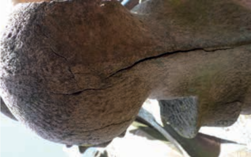
Abb. 87: Riss an einer Krabbe an der südwestlichen Seite des nördlichen Hahnenurms, 31.07.2023 (MBV, T. Borsdorf)
