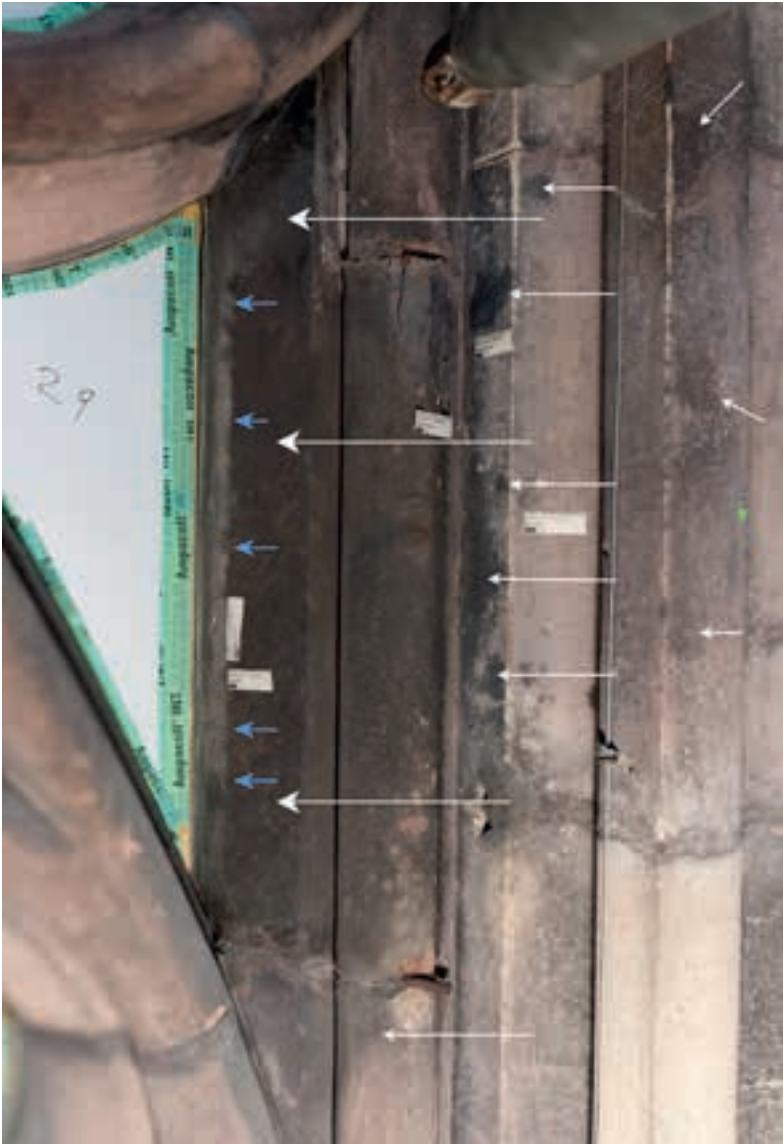
Abb. 61: Die weißen Pfeile weisen auf durch Mangananreicherungen verschwärzte Bereiche. Die blauen Pfeile zeigen auf eine senkrechte ungleichmäßig wellige Linie. Hier könnte in einer früheren Maßnahme Säure mit einem Pinsel aufgetragen worden sein, um die Farbe anzulösen. Den hellen, linken Bereich hatte man wahrscheinlich nicht eingestrichen, so dass deshalb das Mangan dort nicht bis zur Oberfläche migriert ist, 05.05.2023 (J. Quatmann)
