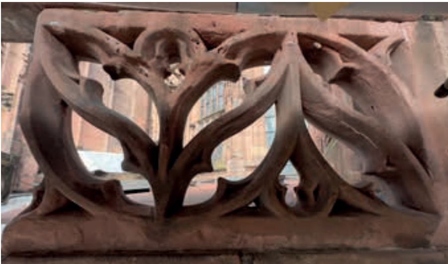
Abb. 43: Maßwerkbrüstung, Joch 13 WS2, Lichtenfels-Krozingen-Kapelle, im Vorzustand, 02.04.2023 (L. Kürten)
