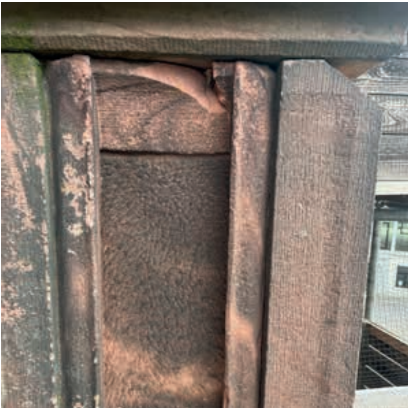
Abb. 89: Schäden durch korrodierte Eisenklammern am Kapellenpfeiler 13 Süd, 07.11.2023 (MBV, T. Borsdorf)
