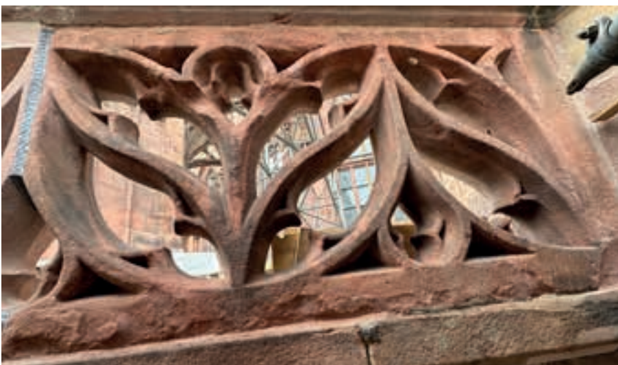
Abb. 44: Maßwerkbrüstung, Joch 13 WS2, Lichtenfels-Krozingen-Kapelle, im Endzustand, 30.03.2023 (L. Kürten)
