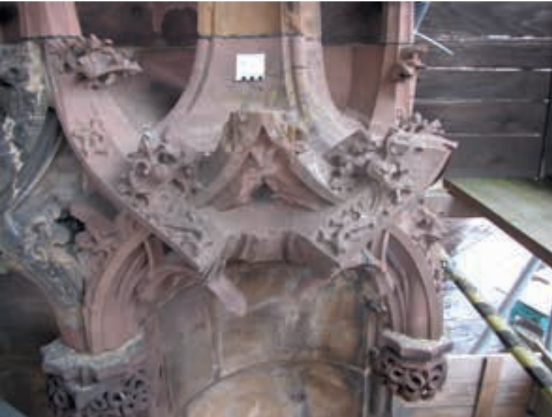
Abb. 21: Der stark geschädigte Baldachin vor dem Ausbau, 09.11.2022 (MBV, A. Schedlbauer)
