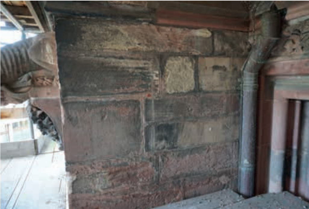
Abb. 45: Vorzustand südliche Wandfläche in Höhe Wasserspeier, 25.05.2020 (MBV, A. Schedlbauer)
