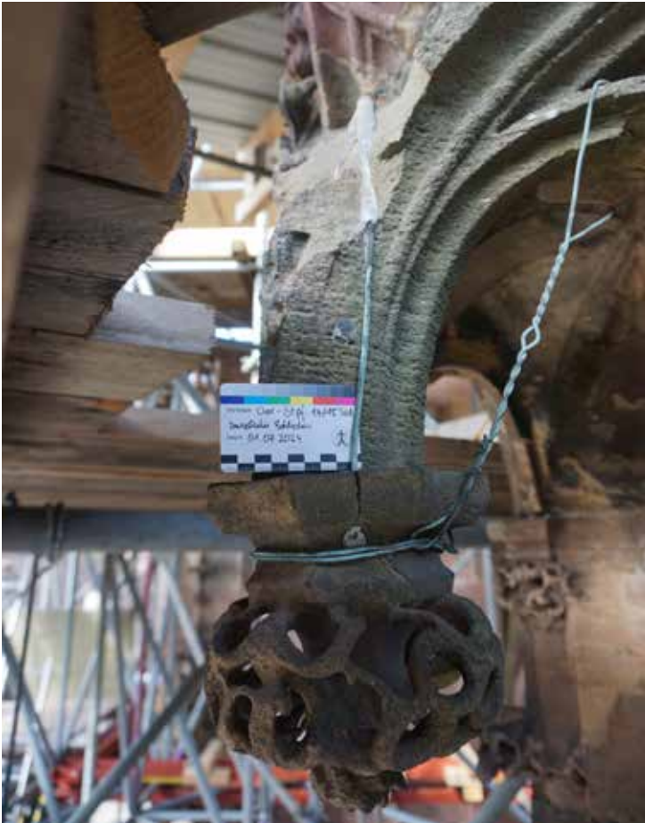
Abb. 5: Abhängling mit darüberliegender Fehlstelle; aufgrund der Rissbildung mittels Kupferdraht gesichert. Die Notsicherung mit eingeleitem Kupferdraht hat wegen der Volumenzunahme des korrodierten Bleis auch zu der großen Fehlstelle geführt. 01.07.2024 (MBV, T. Borsdorf)
