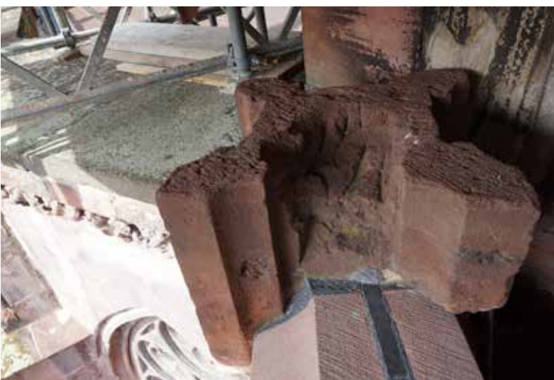
Abb. 12: Der untere Teil der Fiale aus dem 14. Jhd. Der obere Fialenabschluss wurde aufgrund von Steinschäden abgenommen. 25.09.2024 (N. Koch)
