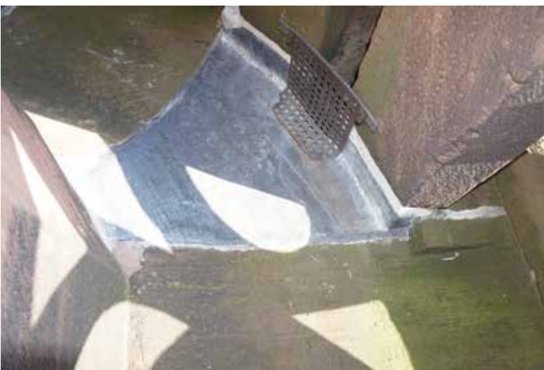
Abb. 3: Wassereinflauf der Hochchorumgangsgalerie in den Strebebogen 18.02.2025 (MBV, A. Schedlbauer)
