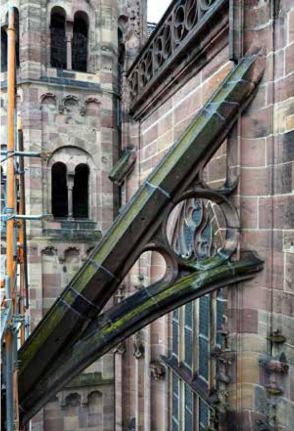
Abb. 11: Strebepfeiler am Strebepfeiler 9/10, Anfang des 16. Jhdts. eingesetzt. Dahinter sind die Ansätze eines nicht ausgeführten Bogens zu sehen. 26.09.2024 (N. Koch)
