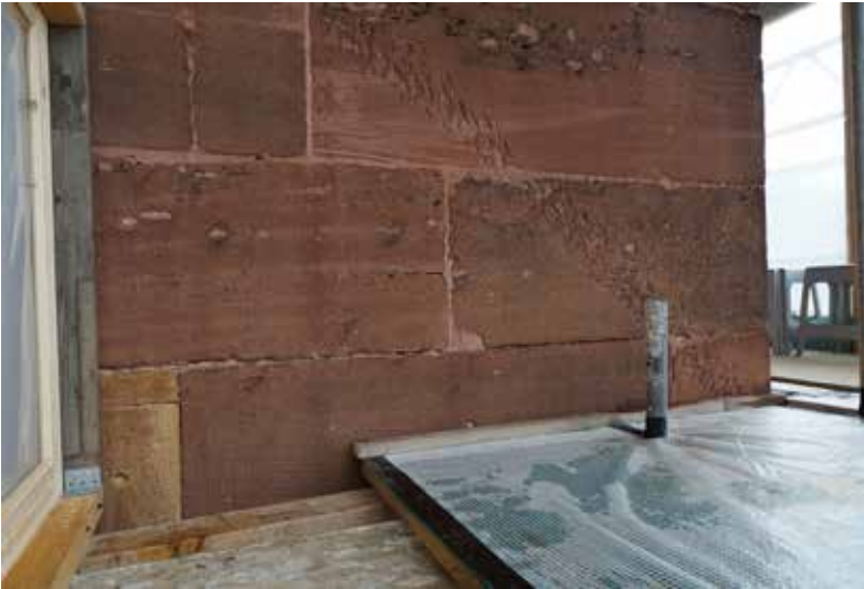
Abb. 13: Spuren eines ehemaligen Dachanschlusses an der Westseite 26.09.2024 (N. Koch)
