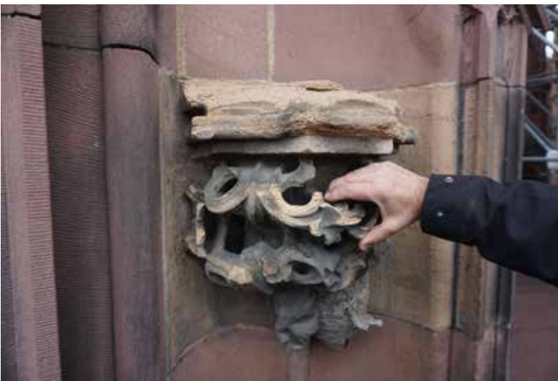
Abb. 5: Korbkonsole am Chorstrebpfeiler 12/13 Süd vor Abnahme des Bruchstücks 25.09.2024 (MBV, H. Koch)
