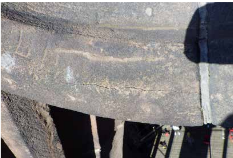
Abb. 1: Neues Rissbild im Maßwerkprofil der Turmpyramide 25.06.2024 (MBV, H. Walz)
