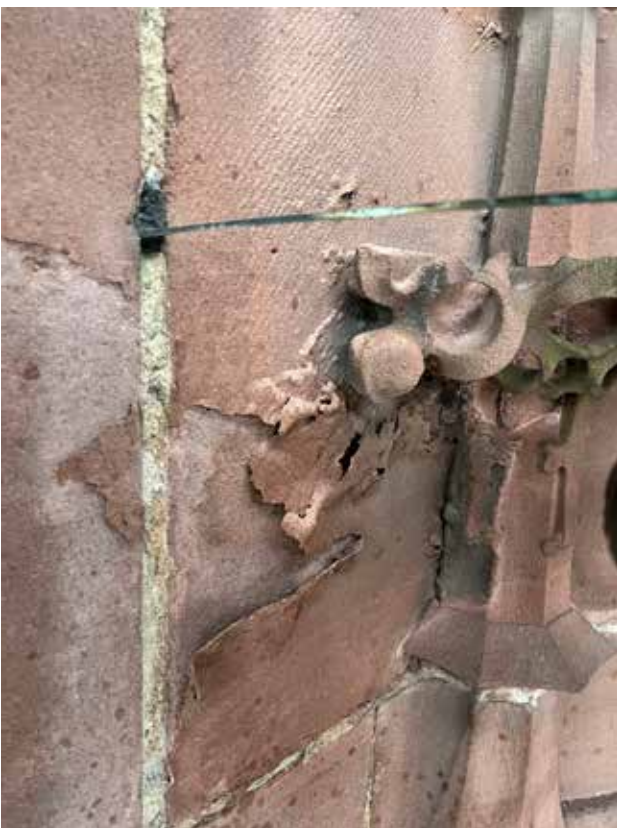
Abb. 8: Blasenförmige Ablösung der obersten Kornlage infolge der verdichteten Oberfläche durch Gipsbildung 25.02.2025 (MBV, T. Borsdorf)
