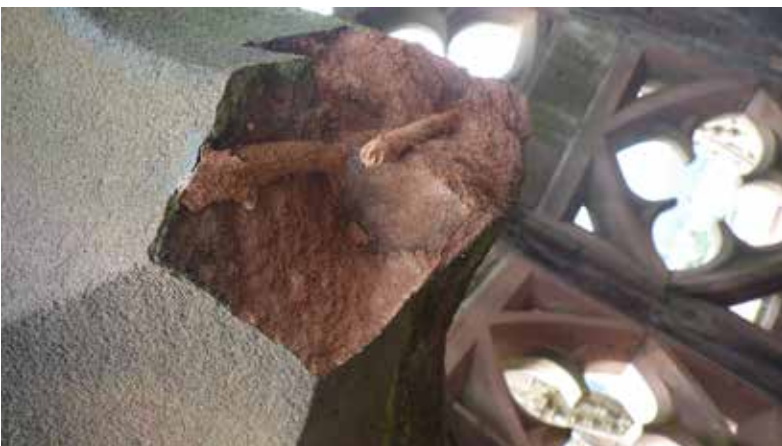
Abb. 4: Hier nach der Abnahme. Deutlich sichtbar die Verdübelung als Ursache 19.06.2024 (MBV, H. Koch)
