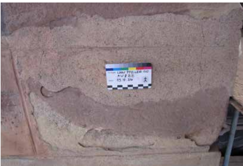
Abb. 1: Zwischenzustand, Westwand unterhalb des Wasserspeiers 19.08.2024 (MBV, S. Eberhardt)
