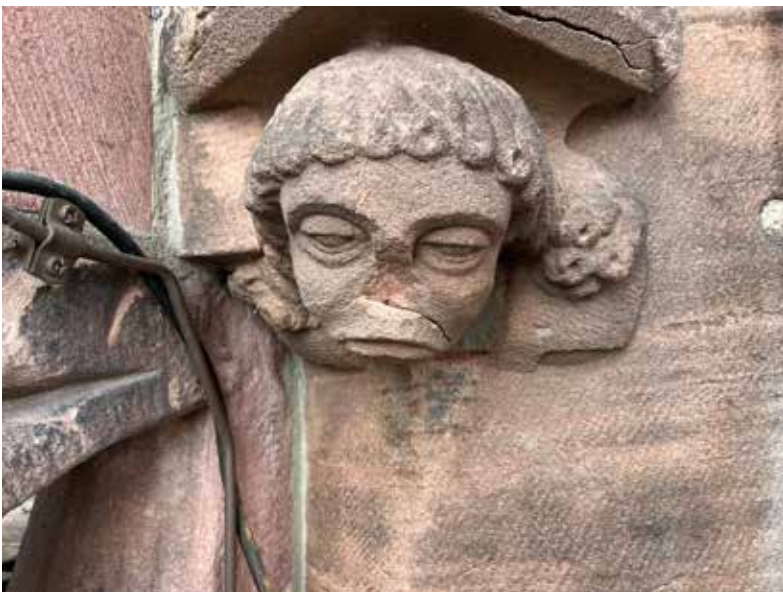
Abb. 1: Konsolkopf am Strebebeyler 14/15 Süd, Vorzustand 23.07.2024 (MBV, T. Borsdorf)
