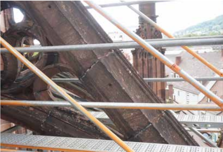
Abb. 1: Schadhafte Bleifuge am Strebebogen 21.08.2024 (MBV, A. Schedlbauer)
