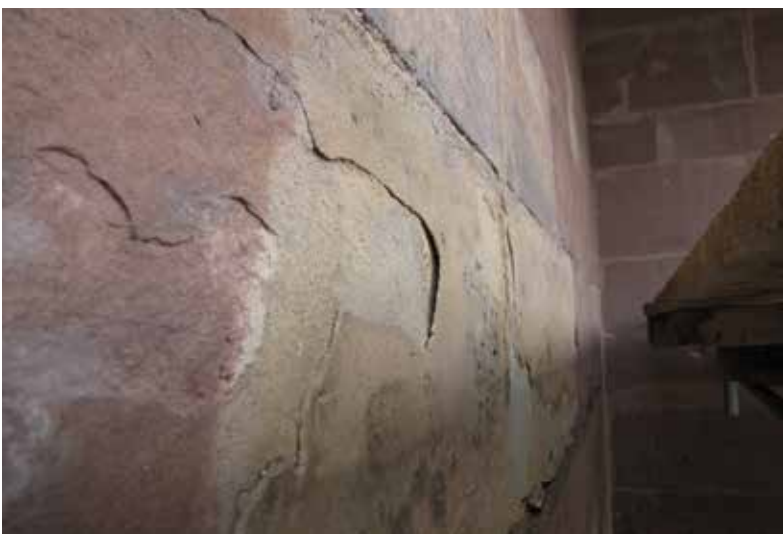
Abb. 1: Schale an der westlichen Seite des Strebepfeilers 0/1 31.07.2024 (MBV, H. Walz)
