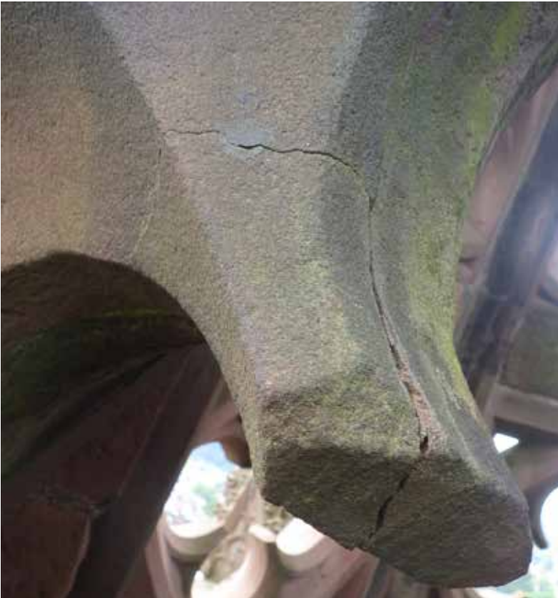
Abb. 3: Rissbildung am südl. Hahnenturm durch Verdübelungen der letzten Restaurierung 19.06.2024 (MBV, H. Koch)
