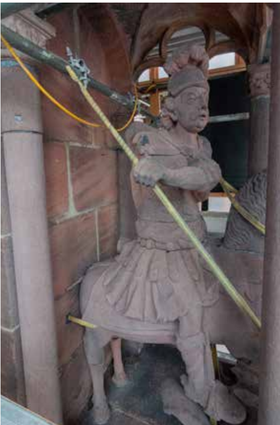
Abb. 2: Reiterstandbild nach der Reinigung. Der rechte Arm war substantiell beschädigt und musste zur Instandsetzung abgenommen werden. 28.02.2025 (J. Quatmann)
