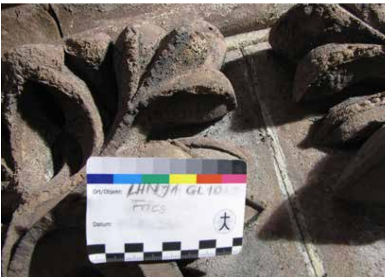
Abb. 1: Blattfries mit Gipskrusten und darunterliegender Mürbezonen. Fugen mit weißem Fugenstrich 14.11.2024 (MBV, S. Eberhardt)
