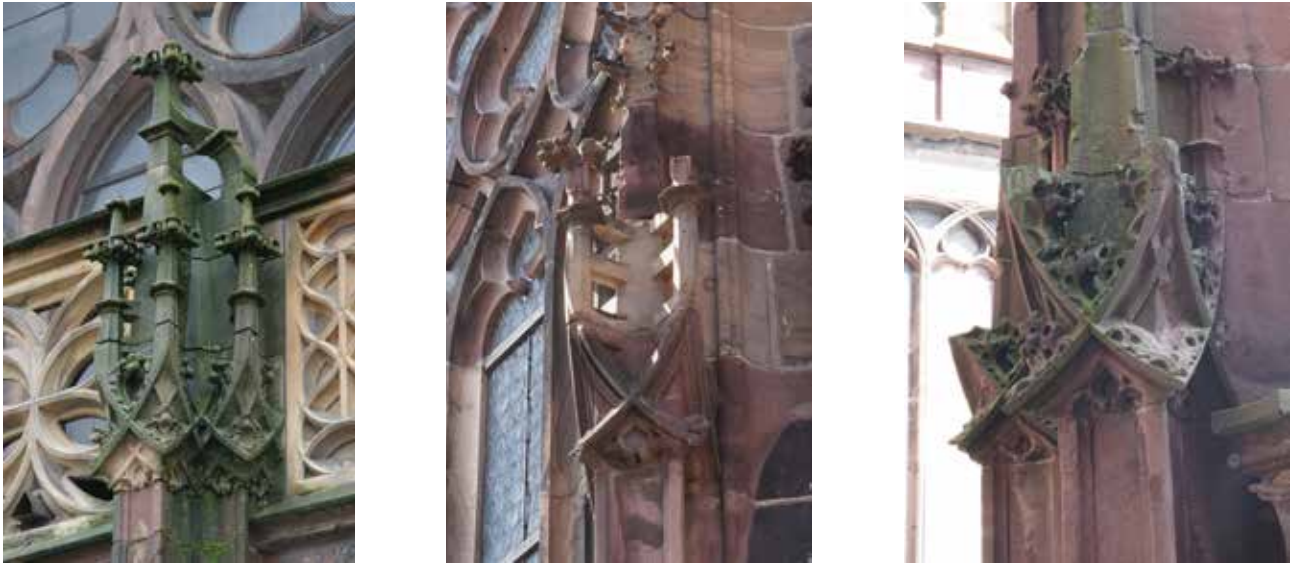
► Abb. 16: Fiale an der Außenfassade der Ölberg-/Grafenkapelle (links), Fiale an der Außenfassade des Hochchors (Mitte) und Fiale am Chorstrebpfeiler 10/11 Süd (rechts).
