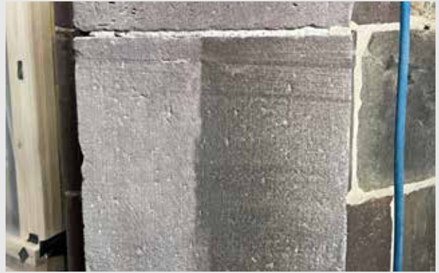
► Abb. 21: Links gereinigte Peilerfläche, rechts ungereinigter Zustand der Peter-und-Pauls-Kapelle (25.9.2025)
