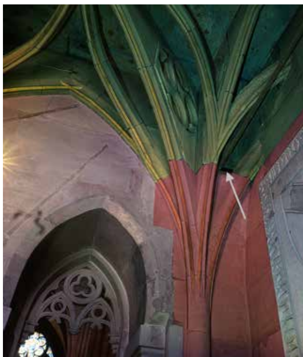
► Abb. 10: Südwestliche Ecke der Ölberg-/Grafenkapelle; rot: 1. Bauphase (um 1480), grün: 2. Bauphase (1557/58), Pfeil: Mauerrücksprung am Übergang der Bauphasen.
