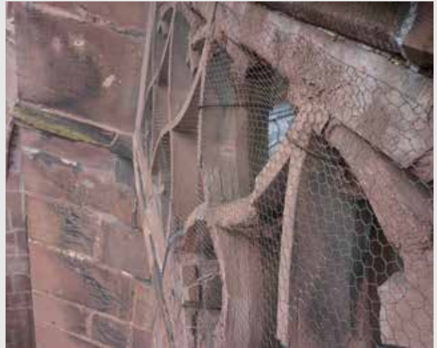
► Abb. 18: Die Schäden an der Maßwerkbrüstung der Nördlichen Kaiserkapelle (14.02.2024).
