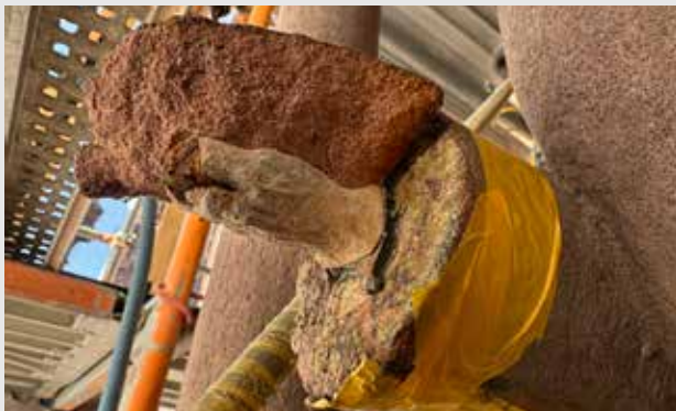
► Abb. 5: Nach Abnahme des rechten Vorderlaufs zeigt sich das Ausmaß der Schäden: Der Stein bricht an den Rissen. Es zeigt sich, der Schaden geht vom bauzeitlichen eingeleiteten Eisendübel aus (08.03.2025).
