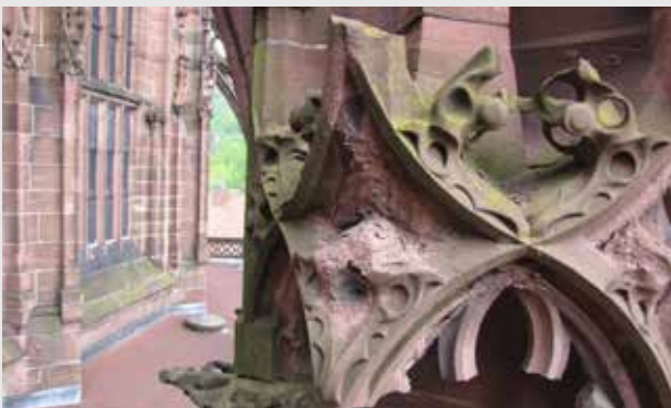
► Abb. 3: Ein Baldachin am Strebepeiler 10/11 Süd mit den typischen Schäden (26.04.2010).
