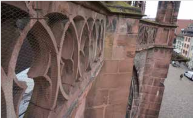
► Abb. 2: Die Maßwerkbrüstung Joche 14 Nord ist von Rissen durchzogen (14.02.2024).
