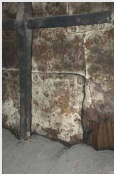
► Abb. 6: Die Fensteröffnung ist von der Innenseite (ehemaliger Archivraum) mit einem hölzernen Fensterladen verschlossen. Im Detail sind die gefassten Blechtafeln sowie das dritte, direkt vor dem Fensterladen befestigte Gitter vor der Reinigung zu sehen.
