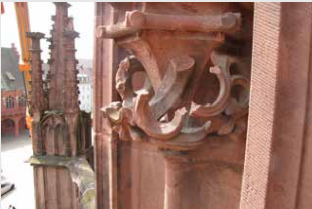
► Abb. 9: Verlust von Steinteilen an einer Konsole des Pfeilers 10/11 Süd (26.04.2010).
