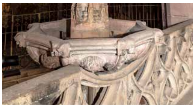
► Abb. 5: Rückseite der Balustrade mit dunklen Verfärbungen am oberen Handlauf.
