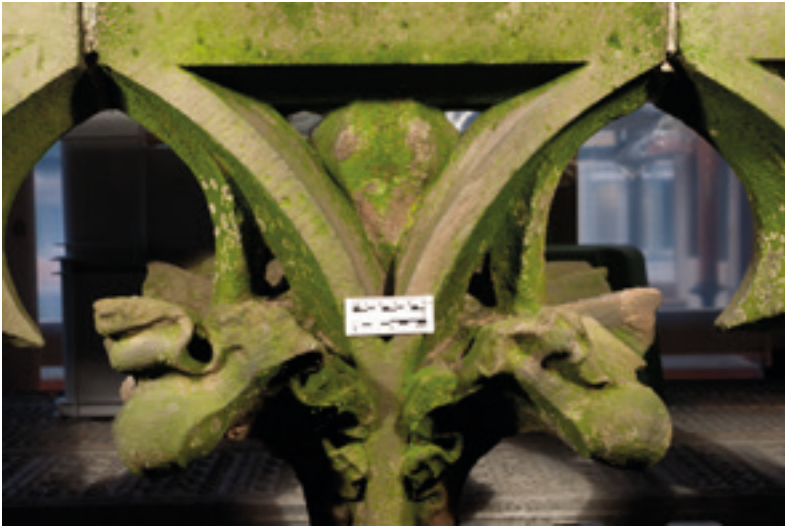
Abb. 3: Rückseite der Brüstung. Angetroffener Zustand 23.04.2025 (J. Quatmann)
