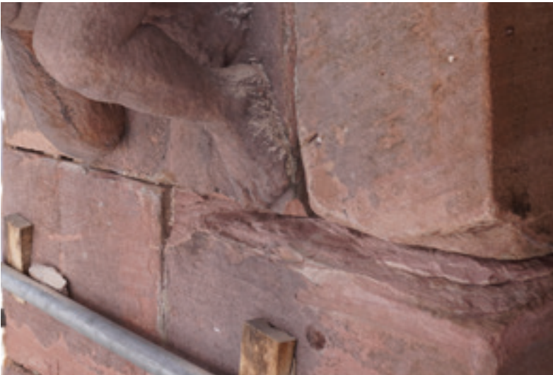
Abb. 14: Deutlich ist hier der Verwitterung des Steines zu erkennen, die eine Vierung notwendig macht. 30.04.2025 (MBV, A. Schedlbauer)
