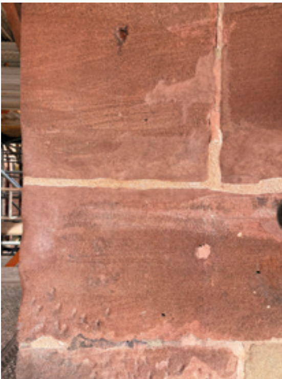
Abb. 10: zeigt die überschlämmte Antragung im Endzustand. 29.10.2025 (L. Kürten)
