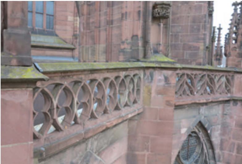
Abb. 1: Zustand der notgesicherten Maßwerkbrüstung bei einer Sicherheitsbefahrung im Jahr 2018 21.11.2018 (MBV, H. Koch)
