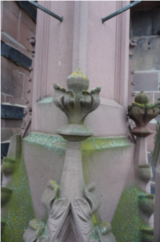
Abb. 3: Unterhalb der Bleifuge ist deutlich der Riss zu erkennen, der es notwendig gemacht hat, die Kreuzblume abzunehmen 24.09.2025 (MBV, T. Borsdorf)
