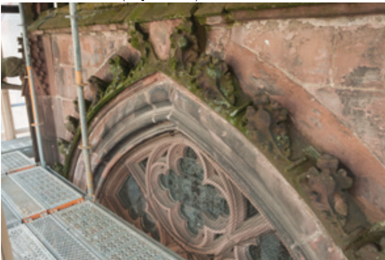
Abb. 7: Angetroffener Zustand 31.03.2025 (J. Quatmann)
