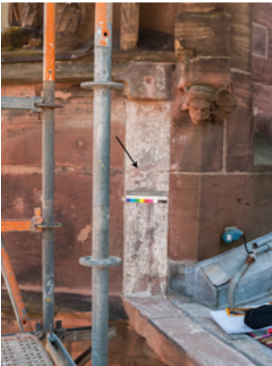
Abb. 2: Die Anstoßstelle der ausgebauten Brüstung zeigt unverwitterte Farbreste einer ehemals roten Flächenbemalung. 07.08.2025 (J. Quatmann)
