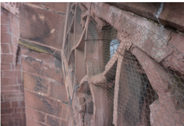
Abb. 1: Zustand der mit Drahtgewebe gesicherten Brüstungen aus Freudenstädter Plattensandstein aus dem Jahr 1936 vor den Maßnahmen 14.02.2024 (MBV, A. Schedlbauer)
