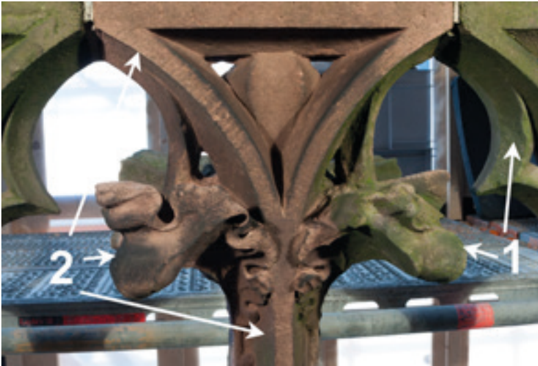
Abb. 5: Rückseite der Brüstung. 1: Bewuchs ist hier trocken entfernt worden. 2: Bereiche wurden mit Wasserhochdruck und mit Heißdampf gereinigt. 28.04.2025 (J. Quatmann)
