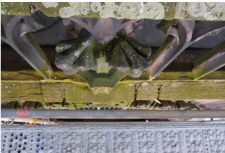
Abb. 14: Dachgesims und darauf sitzendes Brüstungsmaßwerk von oben betrachtet. Der Verwitterungsprozess ist inzwischen weit fortgeschritten. 09.04.2025 (MBV, A. Schedlbauer)
