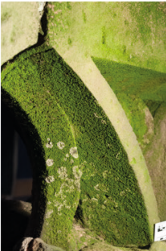
Abb. 4: Rückseite der Brüstung. Detail vom angetroffenen Zustand 23.04.2025 (J. Quatmann)
